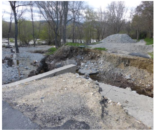
Route coupée par les eaux.
